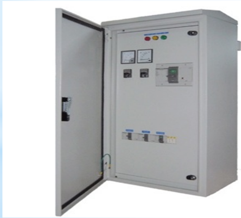
Tủ điện hạ thế 3 pha
